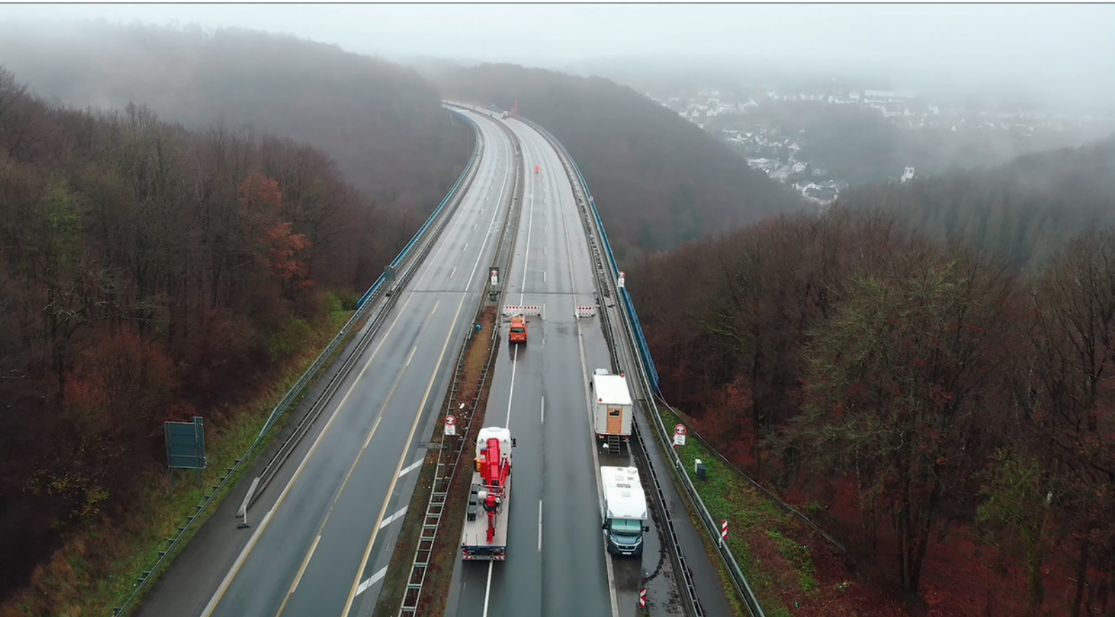
Ein Fall für die „Task Force Brücken“: Die marode Autobahnbrücke Rahmede ist seit dem Dezember 2021 gesperrt. | Foto: Autobahn GmbH
