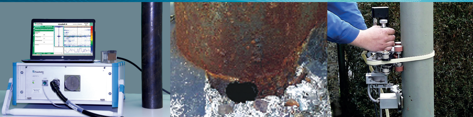
Links: LIMAtest-Prüfsystem®; rechts: Korrosion unterhalb des Erdeintritts
